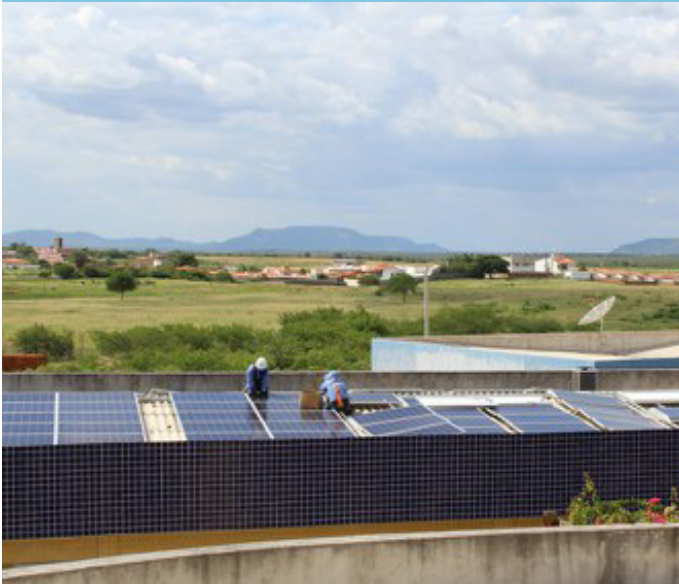
O gerador possui 580 m 2 e é composto por 440 painéis
